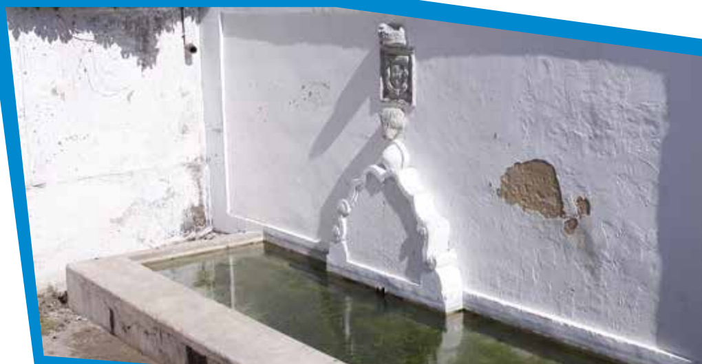
O Chafariz do Cano, no qual ainda se pode observar a cabeça de touro, símbolo do município
